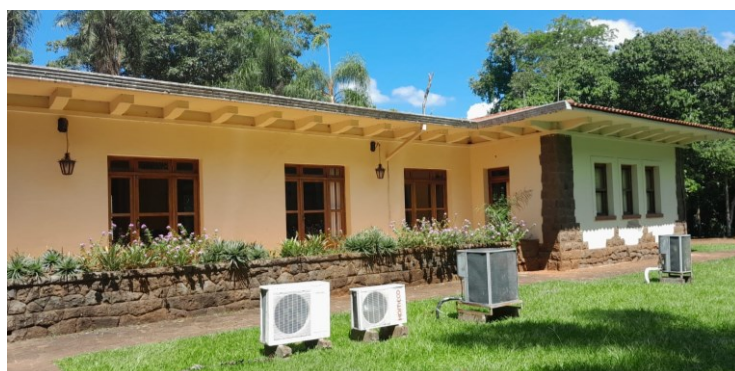
Figura 1: Aparelhos de ar-condicionado no edifício sede do PNI.
