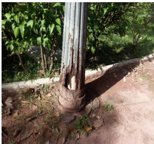
Figura 6: Poste com material corroído
