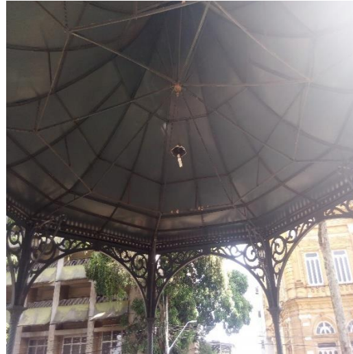
Figura 16: luminária com lâmpada queimada no cloreto
