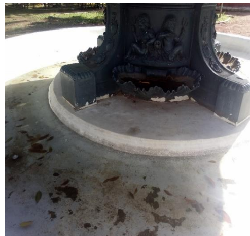
Figura 7: Água acumulada no chafariz
